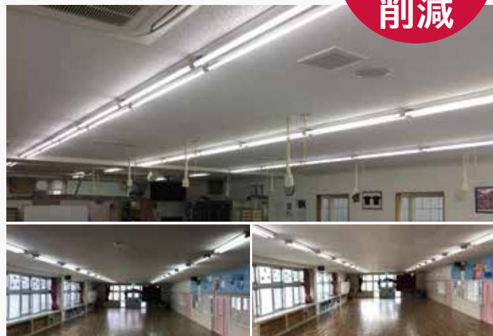
取替前 取替後
